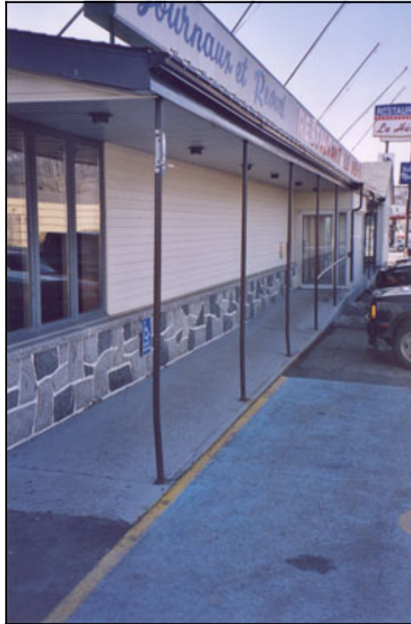
L'aire de manœuvre devant la porte est insuffisante.
