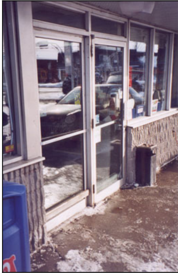
L'aire de manœuvre devant la porte est insuffisante.
